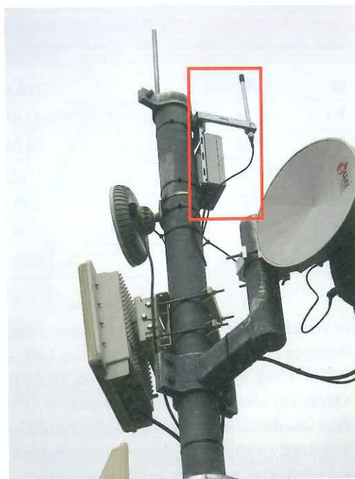
Abb. 6: An einem Mast installiertes LoRaWAN-Gateway (roter Kasten) für die Praxiserprobung
