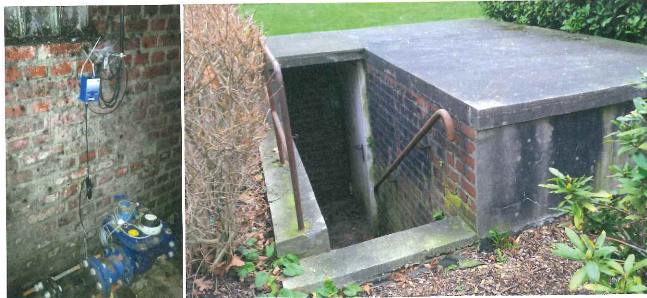
Abb. 7: Vorort-Installation der Wasserzähler mit Kommunikationsbox
